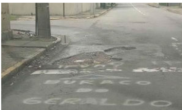
Buraco na Rua 10 de julho, em Setúbal, atrapalha pedestresFoto: @Tiagogsan/Twitter
